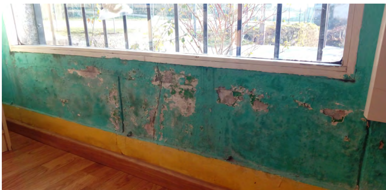
Humidades na fachada da aula principal
